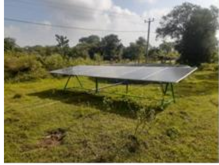
ඡායාරූප අංක 11 - ස්ථාපනය කරන ලද සූර්ය පාලනය පුනර්ජනන අංක 11 - නිවැරදිව පිහිටි සූර්ය පාලනය Photo no 11 - The installed solar panel
